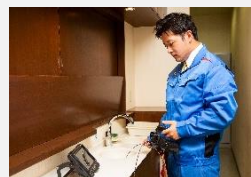
ビデオスコープによる水道管検査
