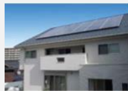
住宅用太陽光発電システム
