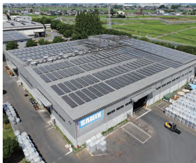
設計から施工まで自社で行える強みを生かし、自社施設への自家消費型太陽光発電導入も進めている(写真は太田工場=プラスチック資源開発工場の例)。自家消費型太陽光発電のモデルケースとして、太陽光発電事業にも生かす。
